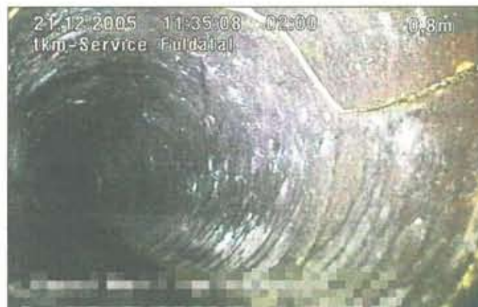
... auf diesem sind die Längsrisse im oberen Bereich deutlich zu erkennen ...
