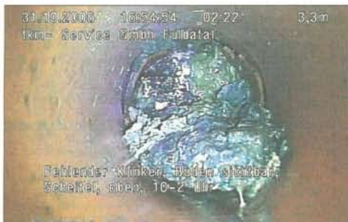
Drei Zustände von Abwasserrohren, wie sie oft anzutreffen sind: Bei diesem hier brachen Teile der Wandung heraus, ...
